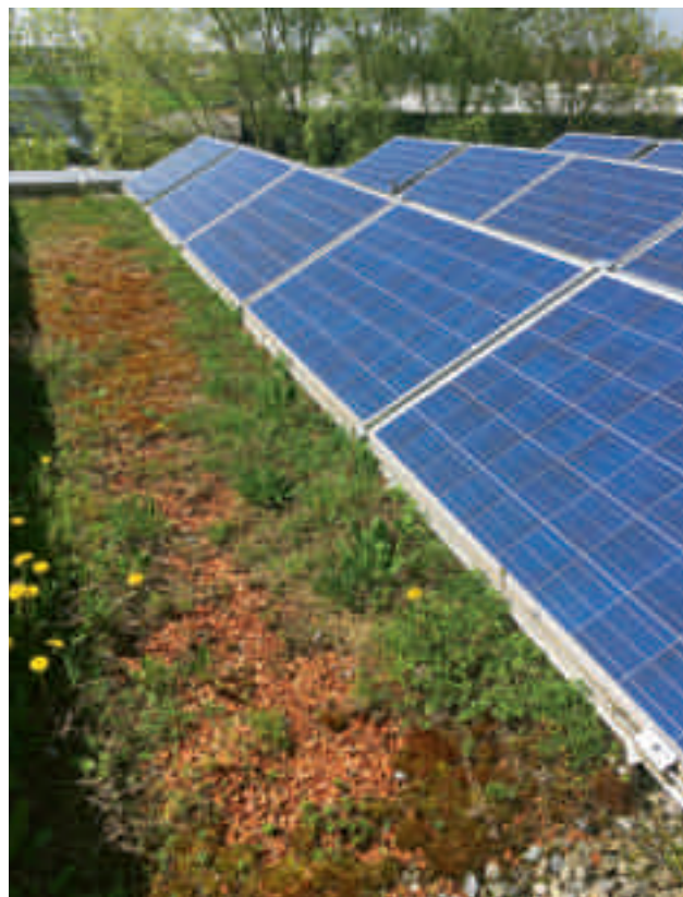
Fig. 5 Bei einem Energie-Gründach werden die Solarpaneele, wie hier auf einem Dach des AVM in Steinach, aufgeständert. Andere Systeme montieren die Paneele etwas erhöht, damit diese nicht durch die Vegetation bedeckt werden. Die Wuchshöhe der Vegetation kann zudem durch eine Reduktion der Substratdicke direkt vor den Paneelen beeinflusst werden [6].
