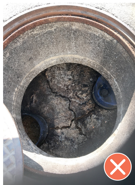
Gli impianti interrati sono più difficili da raggiungere e da pulire e non rappresentano più lo stato della tecnica.
